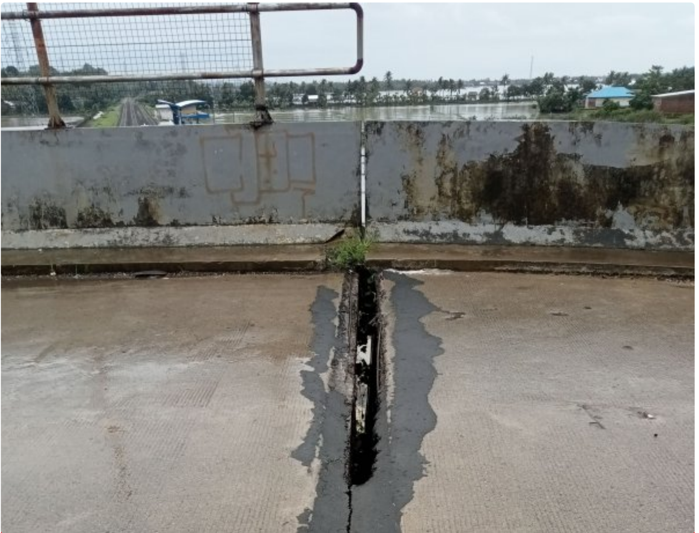
Sambungan jalan fly over Pekkae rusak parah
